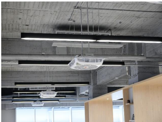
【照片 23：天花板上之循環扇】
